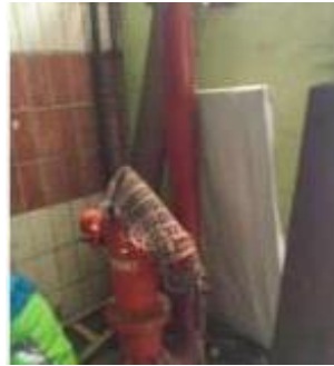
Gambar 6. Salah Satu Hidran Halaman Pada Sudut Pasar Sumber : Dokumentasi Pribadi
