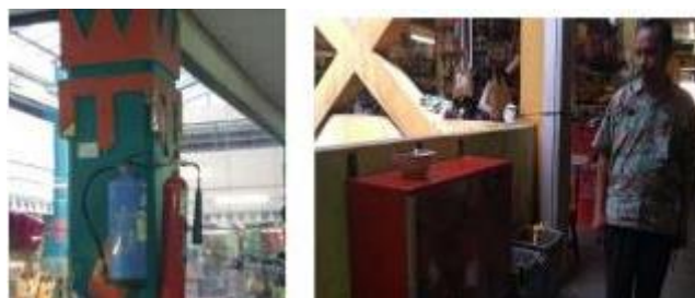
Gambar 11. APAR pada Lantai 3 Pasar Beringharjo Metro & Sisi Tengah Sumber : Dokumentasi Pribadi
