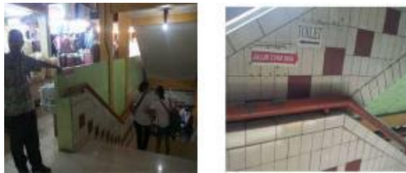
Gambar 13. Cahaya Darurat dan Rambu Petunjuk Evakuasi Lantai 3 Pasar
