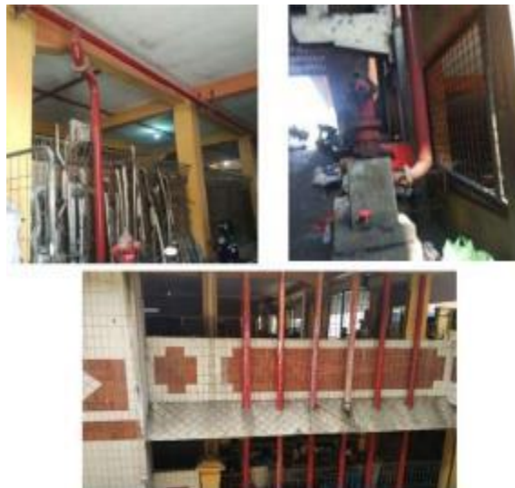
Gambar 10. Siames Connection Dan Sistem Jaringan Hydrant Pada Pasar Beringharjo Sumber : Dokumentasi Pribadi
