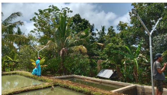
Gb. 6 Instalasi Penerangan
