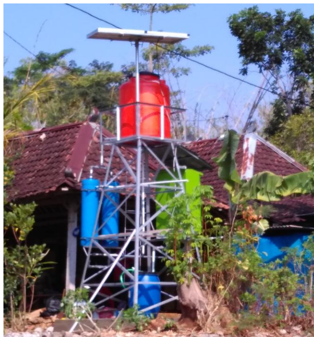
Gambar 2. Pembangkit tenaga surya untuk pengolahan air bersih.
