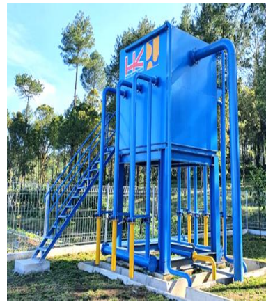
Gambar 2. Jaringan sanitasi air yang dibangun di lokasi huntap
