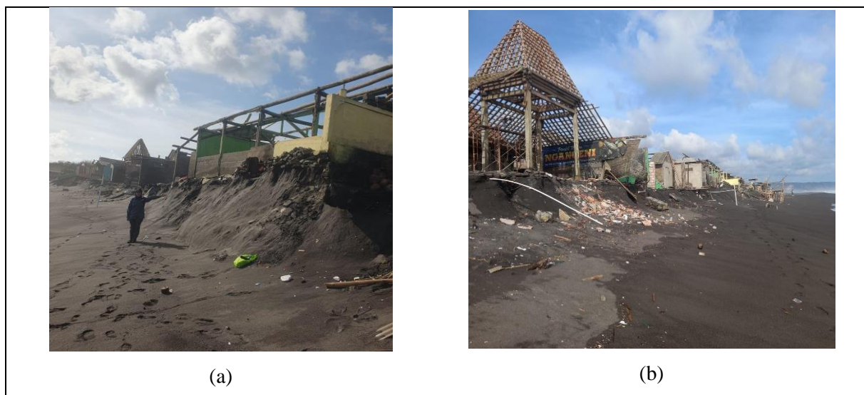
Gambar 3. Abrasi Pantai Depok yang Meruntuhkan Bangunan Permanen dan Semi Permanen.(a) Kerusakan Bangunan di Pantai Depok Akibat Abrasi, Difoto dengan Parameter Manusia. (b) Tebal Abrasi Bervariasi.
